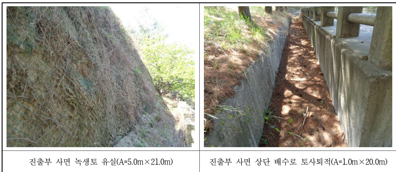
【사진 3.10】 사면 손상현황
